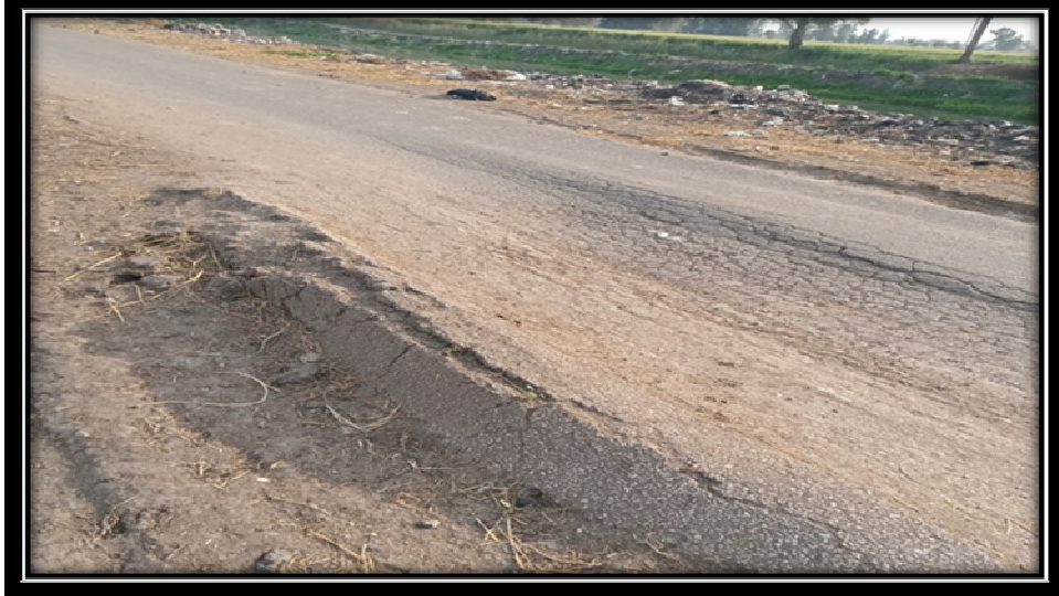
صورة (١) سوء حالة الرصف للطريق المرصوف لعزبة أبو سعيد علي مصرف نمرة (٤) المصدر: الدراسة الميدانية للطالب بتاريخ ٢٠٢٢/٣/٣ م
