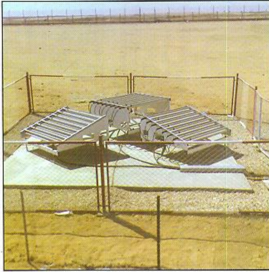
الهوائى الخاص بمحطة قص الرياح
