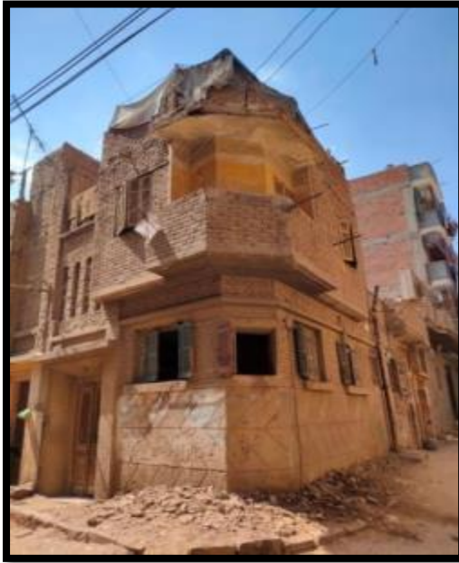
صورة (١٠) جانب من المباني الرديئة بشرع أبو الفضل المالكي بشيخة التحرير.
