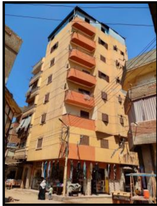
صورة (٢٣) أحد المباني عالية الارتفاع (خمسة طوابق فأكثر) بشياخة عبد الحي شلبي
