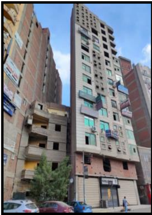
صورة (٢٤) أحد المباني عالية الارتفاع (خمسة طوابق فأكثر) بشارع نعمان الأعصر بشياخة أحمد المنسي
