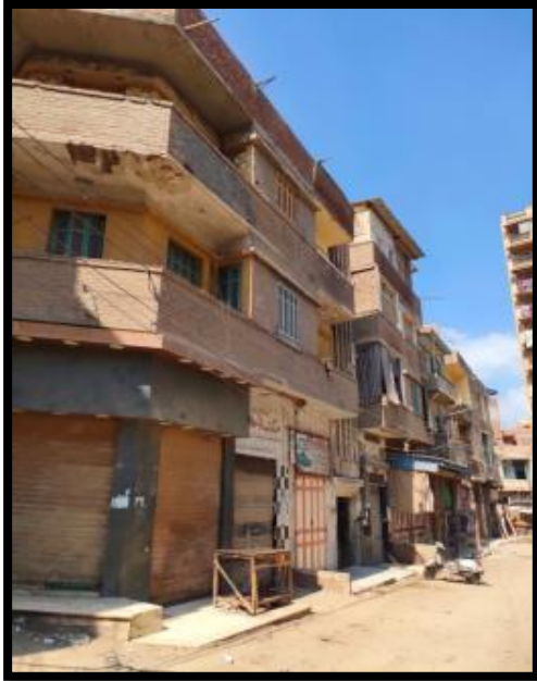
صورة (١٣) جانب من المباني متوسطة الارتفاع (ثلاثة طوابق) بشرع المنسوب بشياخة السبخوي
