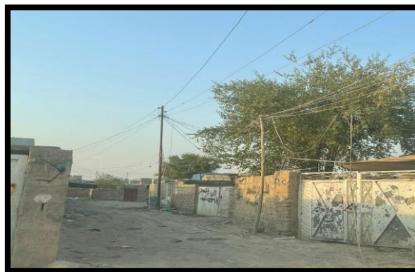
لوحة (١) المباني المهترئة في مدينة سامراء.
