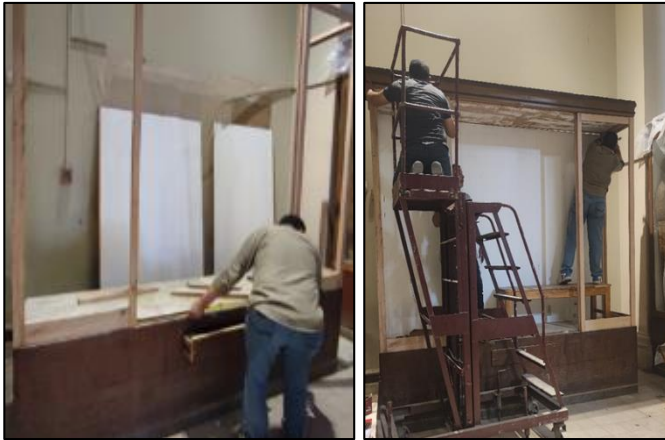
صورة رقم (9)، (10) أثناء مراحل العمل المختلفة لإعادة تأهيل وحدة العرض تمهيداً لإعادة عرض القطع الأثرية بها
