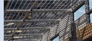
استخدام الخلايا الشمسية بسطح المبنى لتوليد الطاقة.
