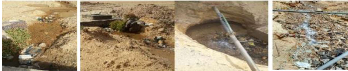
شكل ( 19 ) :يوضح كسور وتسريب بشبكة المياه بمواقع مختلفة بحالة الدراسة دون إصلاح لعدم وجود متابعة أو أجهزة استشعار [الباحث].
