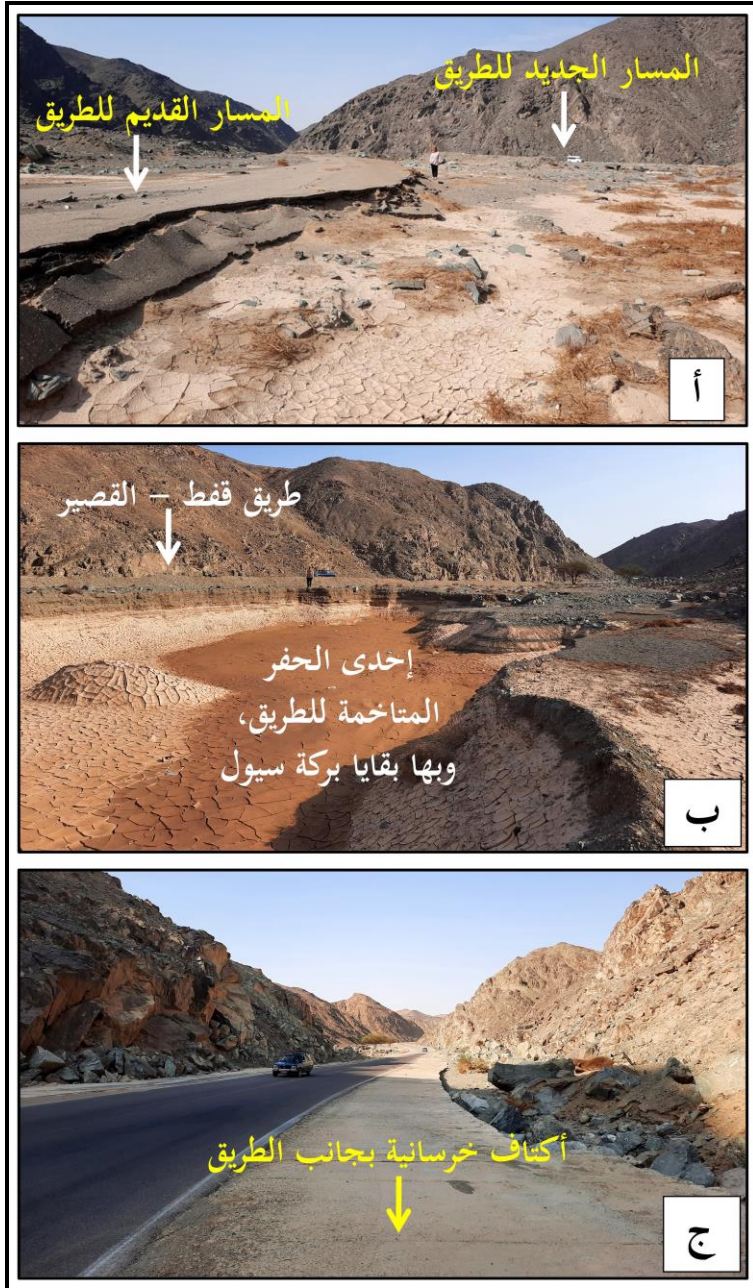
صورة (٥) : أ- تعديل جزء من مسار طريق قفط - القصير لتجنب خطر السيول، ب- إحدى الحفر كبيرة المساحة المتاخمة للطريق، وقد أخذت رواسبها لرفع مستوى الطريق، ج- جزء من طريق قفط - القصير في أحد القطاعات العرضية الضيقة بالوادي، ويلاحظ وجود الأكتاف الخرسانية لحماية الطريق من السيول.
