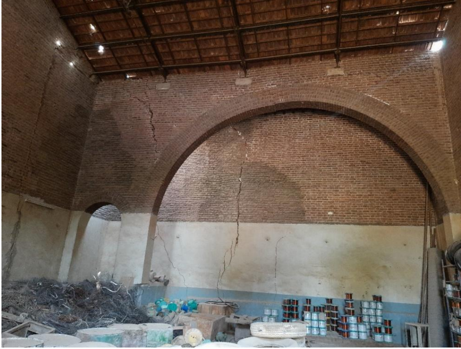
(٤٩) حجرة الغلايات لانكشاير الشرقية من الداخل وممر البواكي من عقدين الذي يبرز بواجهة حجرة الغلايات في الخارج في الواجهة الجنوبية "تصوير الباحث"
