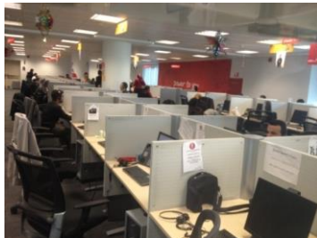
شكل 17: استخدام كشافات من الفلورسنت الغاطسة في منطقة المكاتب
