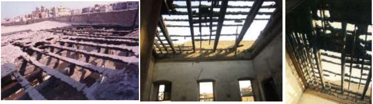
شكل (٣١)، (٣٢)، (٣٣) لقطات توضح شكل السقف حاليا الذي تعرض للتدمير بفعل الحريق ٢
