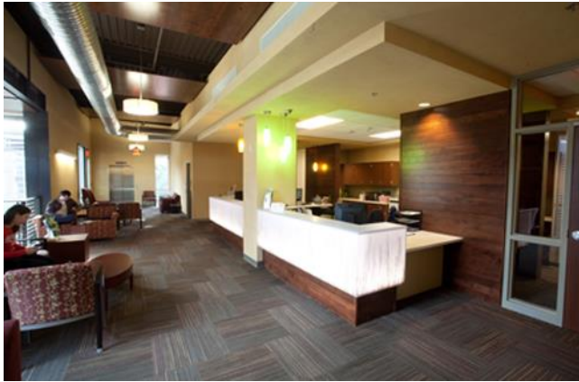
الصورة رقم (8) يوضح معالجات الاسقف حيث تركت بدون معالجة انظمة الالكتروميكانيك ومجاري الهواء للتكييفات.
