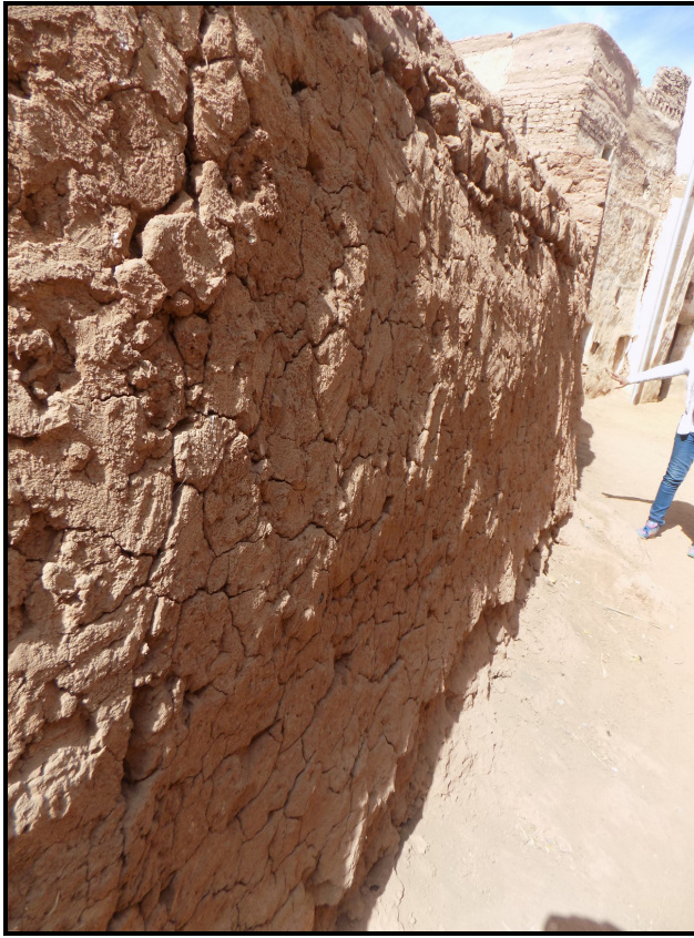
صورة (٣) : تقشر وإنهيار مباني مدينة القصرالأسلامي بالداخل.
