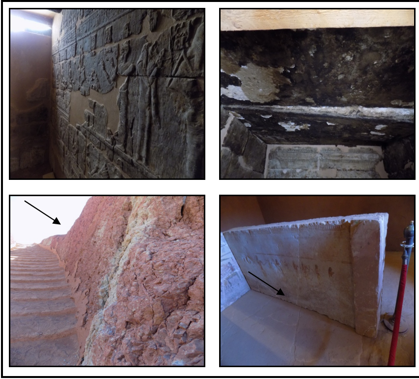
صورة (٢٣) : تأثير الرطوبة على أسقف وجدران وسلم معبد خنتيكا أحد ملوك الأسرة السادسة بالداخلة.
