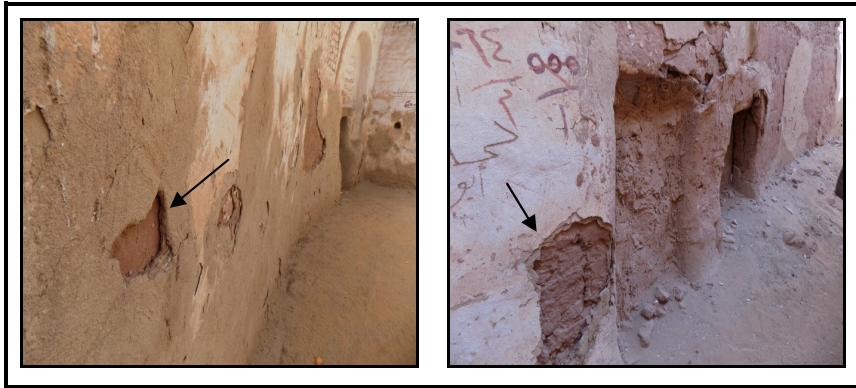
صورة (٢٢) : تأثير الرطوبة على جدران المنازل والشوارع بمدينة بلاط القديمة بالداخلة.
