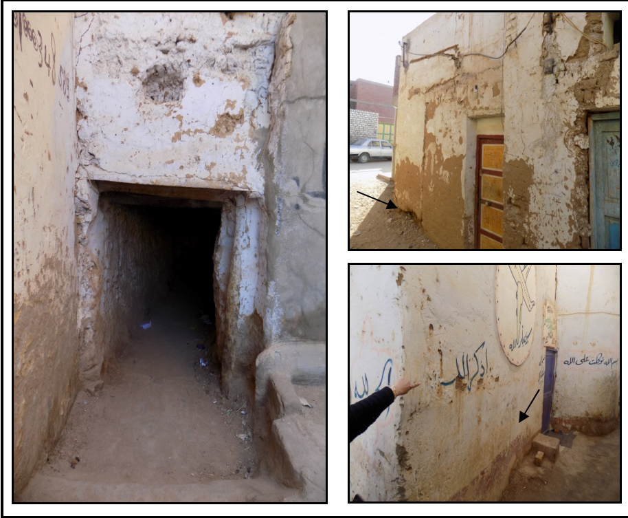
صورة (١٣) : تأثير الرطوبة على مدينة الخارجة القديمة القديمة أحد المزارات الأثر.
