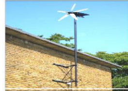
شكل (38): يوضح التوربينات الصغيرة على المبنى.
