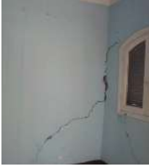
شكل (32): صورة لشروخ داخل أحد مساكن الطارف الجديدة [25]
