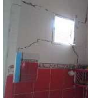
شكل (31): صورة لشروخ داخل أحد مساكن الطارف الجديدة [25]
