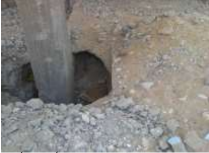
شكل (34): صورة لحدوث هبوط بأرضية أحد مساكن الطارف الجديدة [25]
