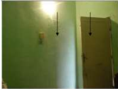
شكل (70): صورة لمسكن قام بتعديل مدخل غرفة الضيوف وعزلها عن المسكن [25]
