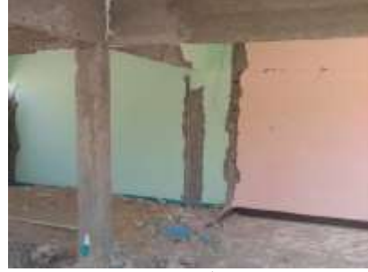
شكل (33): صورة لمسكن حدثت به شروخ أدت إلى إزالة الحوائط تماما ليعاد بنائه [25]
