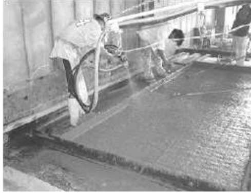
شكل (4): يوضح تصنيع وحدات (GRC) ذات المقاومة عالية للاجهادات في قطاعات دقيقة
