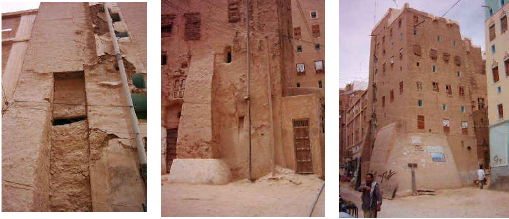
شكل ٩: التلوث البصري الناشئ من استخدام طريقة الإسناد الخارجي للجدران والأسقف بواسطة المعاتن. (لصور إلى اليمين والوسط)، مشكلات تمديدات الصرف الصحي في المباني الطينية (الصورة إلى اليسار).
