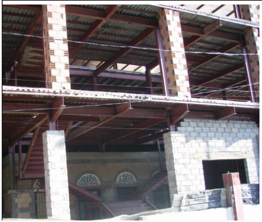
شكل (9) مبنى تجاري حديث قيد الانشاء ويلاحظ المبنى القديم بداخله مازال قائماً -احدي طرق إعادة استثمار الأرض المكان : شارع حده تقاطع شارع جبوتي
