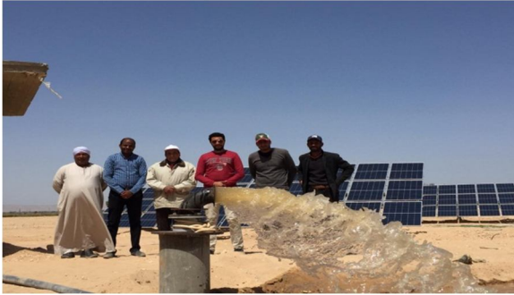
صورة (٨) محطة طاقة شمسية ٣٠ كيلو وات لتشغيل موتور ٤٠ حصان الموقع كرام قنا ٢٠١٨/٣/١٧ م.
