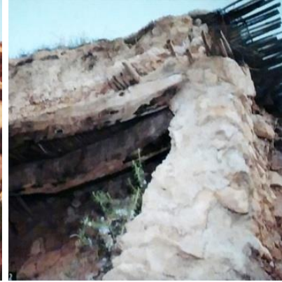
صورة (٢٦ و ٢٧) الاردن بلدة Fuhais – طبقات سميكة معقدة – هذا النوع مكون من ثلاث طبقات هي: طبقة بنائية من جذوع النخل structural layer وطبقة داعمة ما اطار للصب sacrifice framework وطبقة الحشو filling layer التي تكوّن الارضية الحقيقية.
