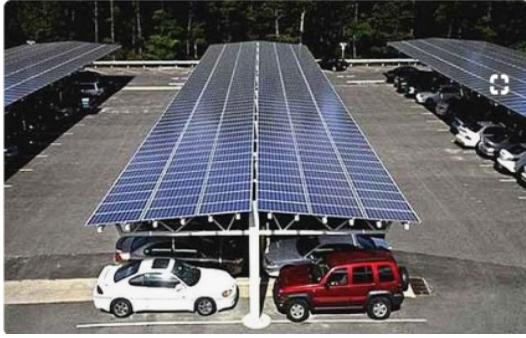
شكل (٤) يوضح استغلال الطاقة الشمسية في مواقف انتظار السيارات لإنتاج الطاقة الكهربائية http://solarenergyworld.work
