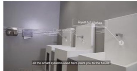
شكل رقم (٢٤): يوضح الحساسات الآلية لمغاسل الوضوء بدورات المياه - تصوير الباحثة
