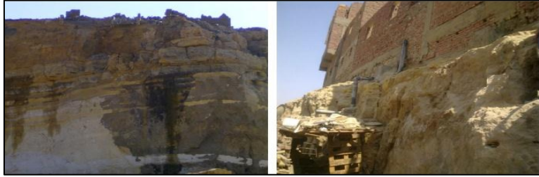
(صورة ٩) تسرب المياه من الجروف الرأسية بمنطقة الدويقة على المنحدر الغربي للهضبة
