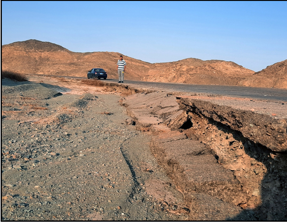
صورة (٤) : تعرض أجزاء من طريق قفط - القصير للتقويض السفلي والسقوط،
