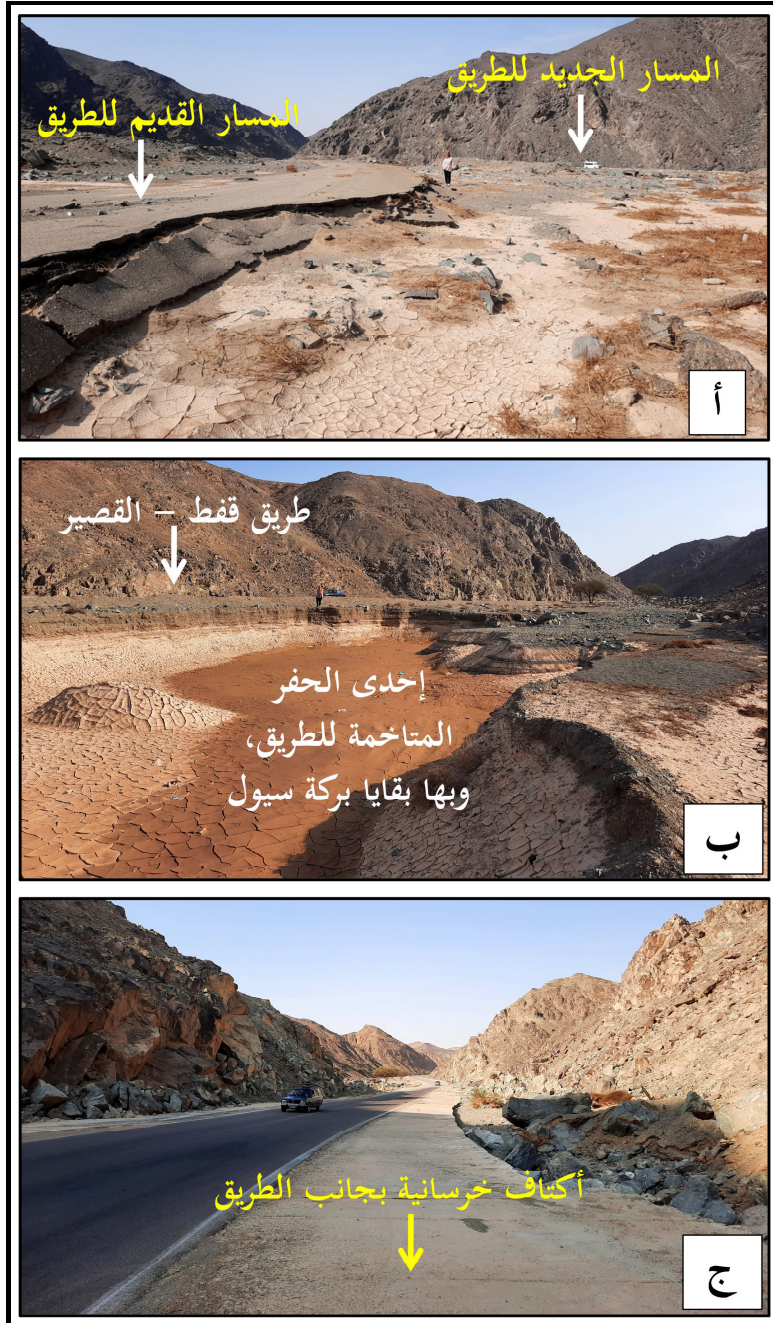
صورة (٥) : أ- تعديل جزء من مسار طريق قفط - القصير لتجنب خطر السيول، ب- إحدى الحفر كبيرة المساحة المتاخمة للطريق، وقد أخذت رواسيها لرفع مستوى الطريق، ج- جزء من طريق قفط - القصير في أحد القطاعات العرضية الضيقة بالوادي، ويلاحظ وجود الأكتاف الخرسانية لحماية الطريق من السيول.
