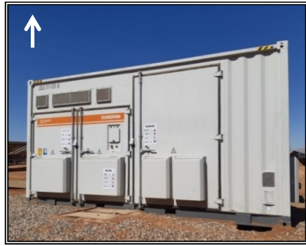
صورة (٥) : محول لنقل الكهرباء في محطة إنفينيتي.
