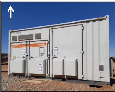
صورة (٦) : غرفة التحكم بمحطة محولات بنبان (٣).
