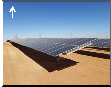
صورة (٣) : الألواح الشمسية في محطة إنفينيتي.
