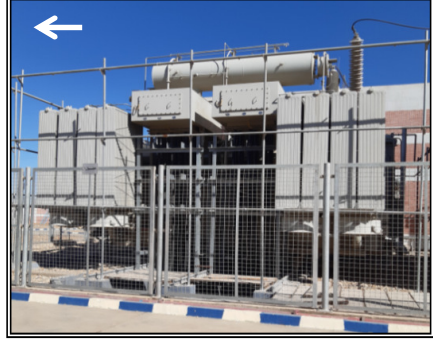
صورة (١) : محولات رفع الجهد بمحطة بنبان (٢).
