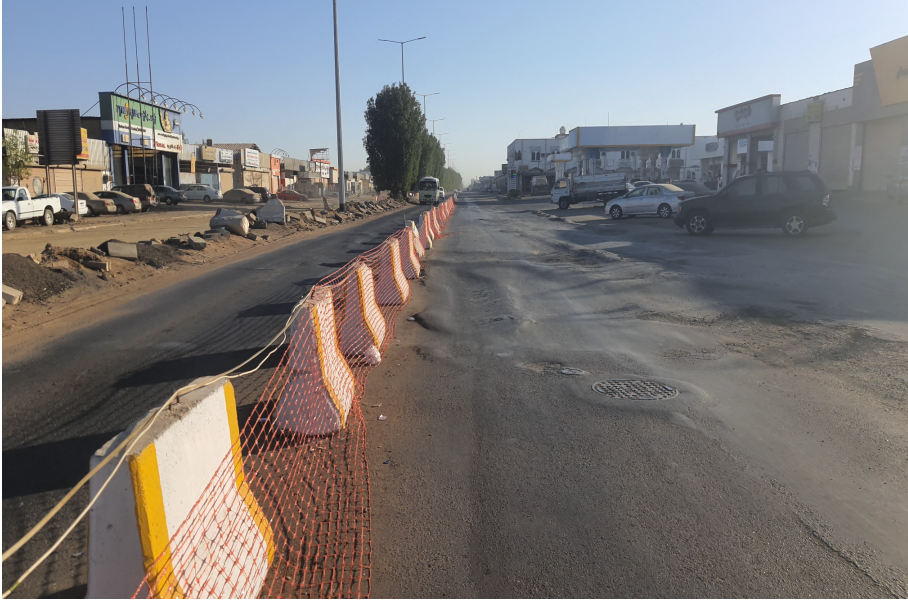
(أ) هبوط أجزاء من الطريق بفعل ارتفاع منسوب المياه الجوفية.
