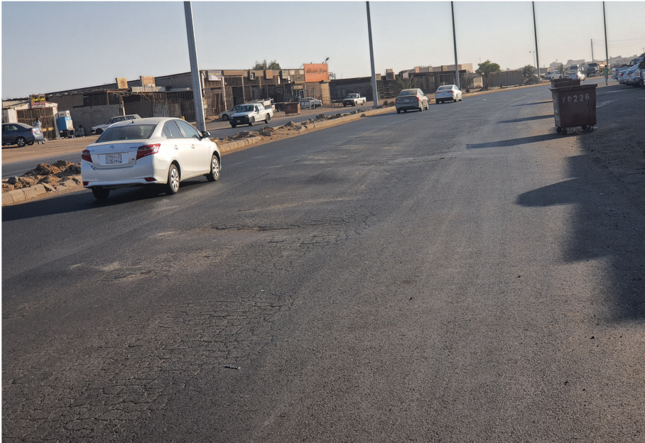
(ب) تشققات طبقة الأسفلت بفعل ارتفاع منسوب المياه الجوفية.
