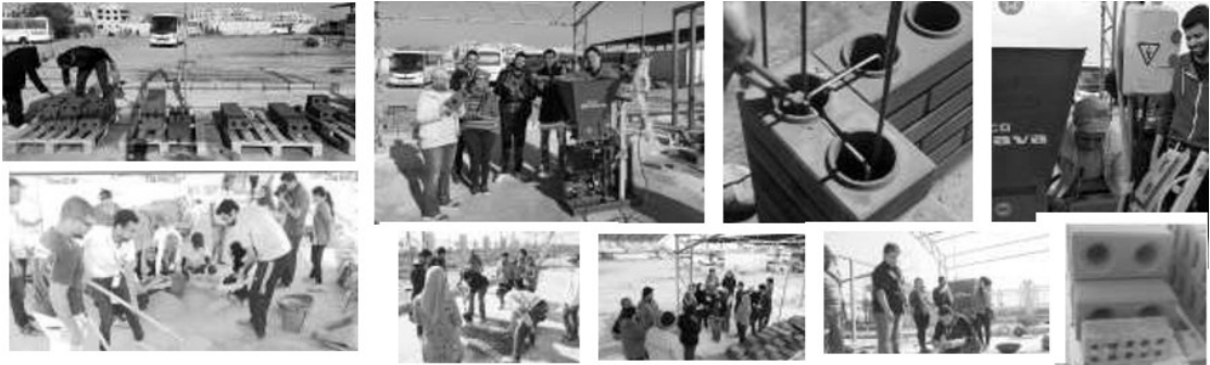
شكل رقم ٦ - فريق العمل بالمركز البحثي أثناء العمل في إنتاج الطوب (المصدر كلية الهندسة جامعة أكتوبر للعلوم الحديثة والآداب- مركز عمارة الأرض)
