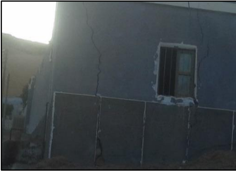
شكل ( ٢٤ ) تدمير المباني وتشريح اسوار المساكن بسبب زحف الرمال
