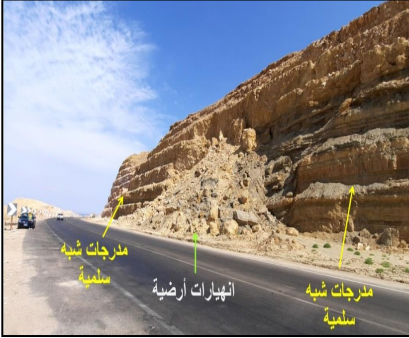
صورة (٨) انهيارات أرضية في جزء من طريق العين السخنة - الزعفرانة جنوب وادي قصب وغرب قرية تلال السياحية (ناظرًا صوب الجنوب الشرقي)
