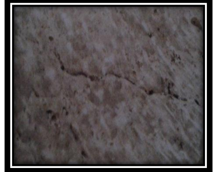
صورة (٣٠) شقوق نتيجة الاجهادات والضغوط الناتجة عن تكون بلورات الأملاح بمقبرة امنحات بنى حسن .
