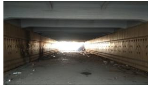
شكل (27) صورة توضح حالة النفق من الداخل وعدم إضاءته وتهويته - المصدر الباحث
