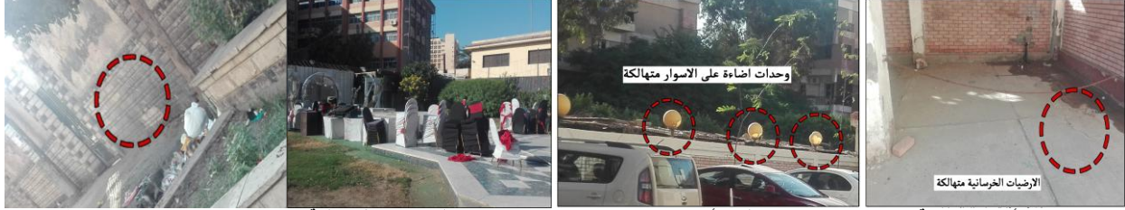
شكل (17) الأرضيات متهاكة شكل (18) تشطيب الأسوار متهاك شكل (19) مناطق الجلوس غير مظلة شكل (20) وحدات الإضاءة متهاكة
