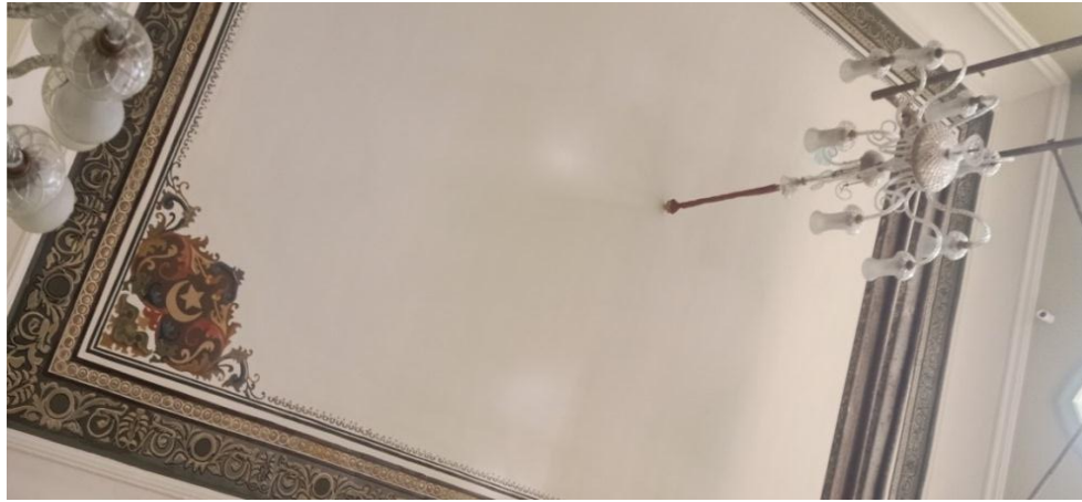
لوحة (١٢): سقف الغرفة الوسطى، الجناح الجنوبي، سراي الجبلية، تصوير الباحثة.
