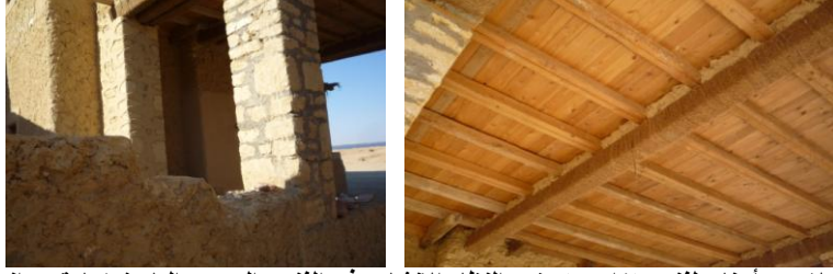
شكل (7) صورة لاحدى أجناح لفندق تزارى توضح النظام الإنشائى فى الفندق المصدر الباحث زيارة ميدانية .
