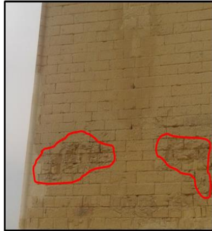
صورة (٢١): تشظي وتراجع بقصر قارون
