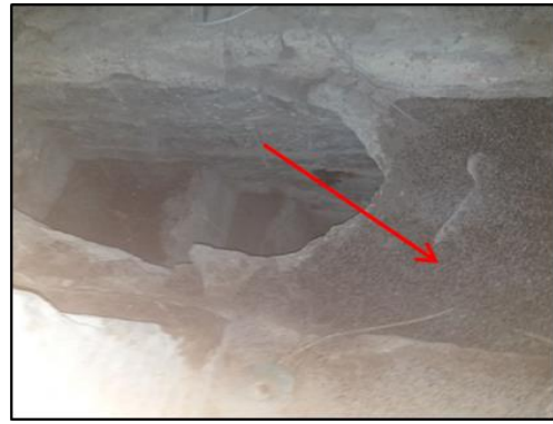
صورة (١٤): تأثير روث الخفافيش بقصر قارون
