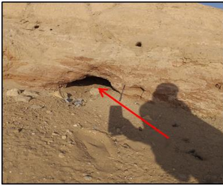
صورة (١٥): الأكسدة بقصر البنات
