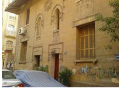
شكل(32) إستخدام كتابات على الحائط متنوعة تلوث حوائط المباني
