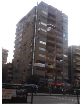
شكل (8) مداخن المطاعم تلوث المباني
