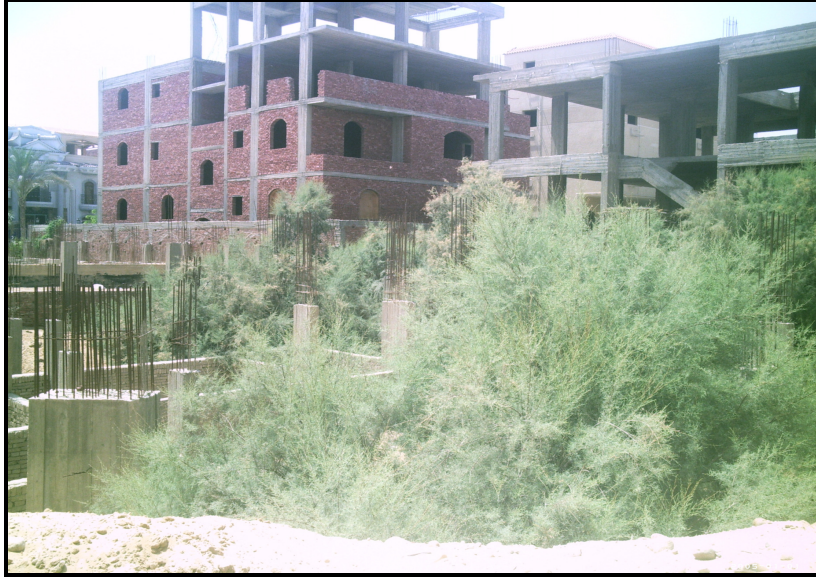
صورة (٧) : المياه الجوفية تغزو أساسات المباني وتظهر الأعمدة الخرسانية ناصية شارع رفاعة الطهطاوي - المنطقة الثانية - الحي السادس.
