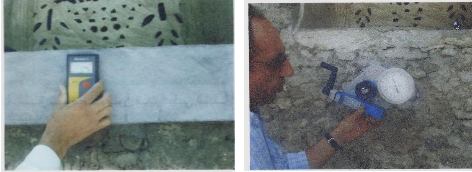
شكل رقم (9)، (10) اختبار Pull-out test لقياس قوة تماسك بين الحجر والطبقة التحضيرية المصدر: تكنولوجيا الترميم الحديثة آلية لاستمرار حياة المباني التراثية، ص 215
