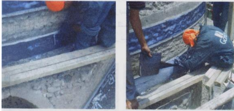
شكل رقم (12)، (13) توضح لصق الكربون فايبر علي الطبقة التحضيرية المصدر: تكنولوجيا الترميم الحديثة آلية لاستمرار حياة المباني التراثية، ص 216
