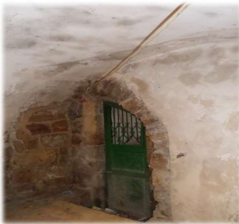
لوحة ١٦ توضح أثر الرطوبة على الجدران الداخلية
