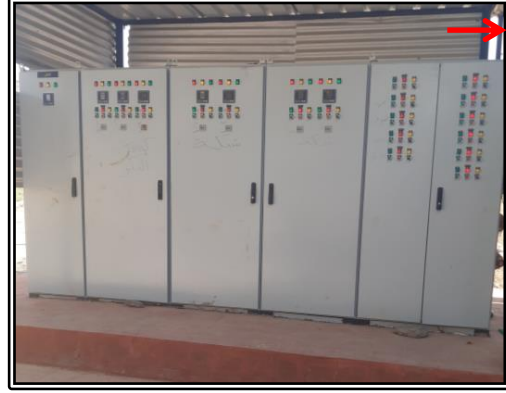
صورة (١) لوحة الكهرباء في محطة الزهراء (١)
