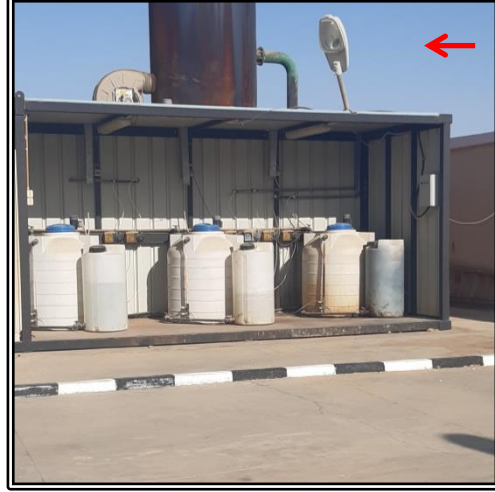
صورة (٧) وحدة الكيمياء في محطة القلعة الجديدة.
