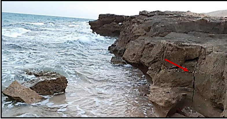
شكل (٢٨) انفصال كتل من صخور الجروف البحرية وتساقطها في الخليج وأس الرفوانة نتيجة تراكم الأملاح داخل الشقوق والفواصل - ناظراً صوب الجنوب الشرقي
