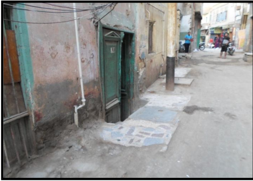
صورة (٩) انخفاض عتبات المباني السكنية بمنطقة النواة .
