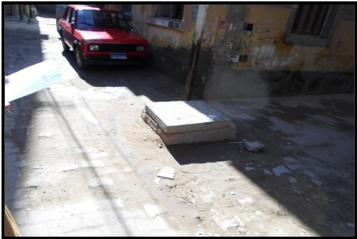
صورة (١١) ارتفاع غطاءات الصرف الصحي بمنطقة النواة .
