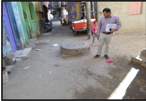
صورة (١٠) ارتفاع غطاءات الصرف الصحي بمنطقة عزبة الصفيح .
