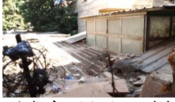
شكل (10) إستخدام سطح المبنى في تخزين المهملات المصدر : الباحث
