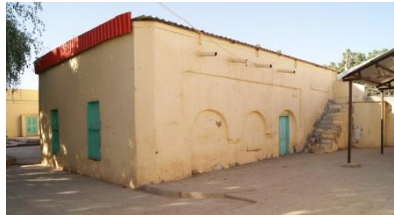
لوحة 81 : الواجهة الشمالية، وبانكتها المسدودة، والواجهة الشرقية قبل الترميم. تصوير الباحثة 2015م.
