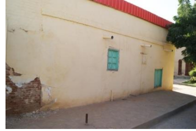
لوحة 85 : الواجهة الغربية وفتحاتها المسدودة قبل الترميم. تصوير الباحثة 2015م
