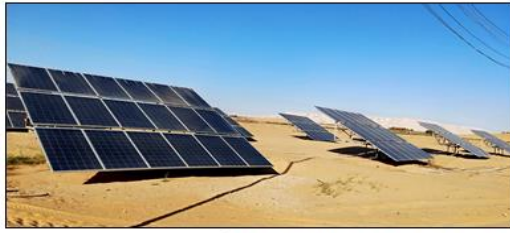
من تصوير الباحثة، ٧ مارس ٢٠٢١، الساعة الثانية ظهرًا. محطة طاقة شمسية بتساسية متحرك بقدره ٤٠ كيلو وات بقرية الراشدة/مركز الداخلة
