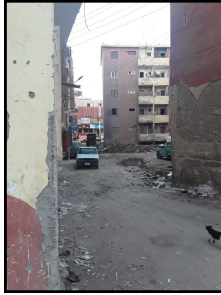
صورة (١) : تدهور المباني السكنية بمدينة أبنوب.
