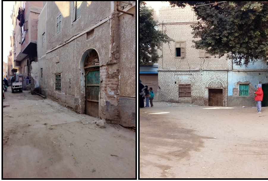
صورة (٢) : انخفاض عتبات المباني السكنية بمدينة القوصية.
