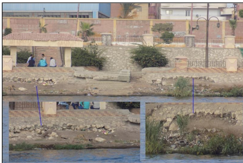
صورة (١١): تآكل أحد أرصفة مراسي المراكب في الجانب الشرقي لمجرى فرع رشيد بمدينة دسوق بمحافظة كفر الشيخ بفعل عمليات النحت. اتجاه التصوير: ناظرا صوب الشمال الشرقي تاريخ التصوير: ٢٠١٥/٦/١٣
