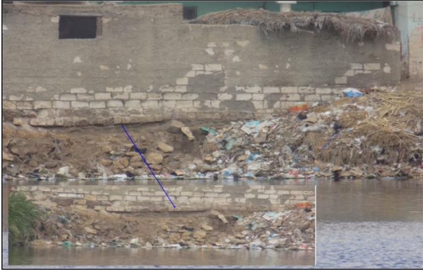
صورة (١٥): آثار عمليات النحت على أرصفة المنازل بالجانب الشرقي لمجرى فرع رشيد وتآكل الرصيف بالكامل وانكشاف أساسات المباني بعزبة الملا بمحافظة كفر الشيخ
