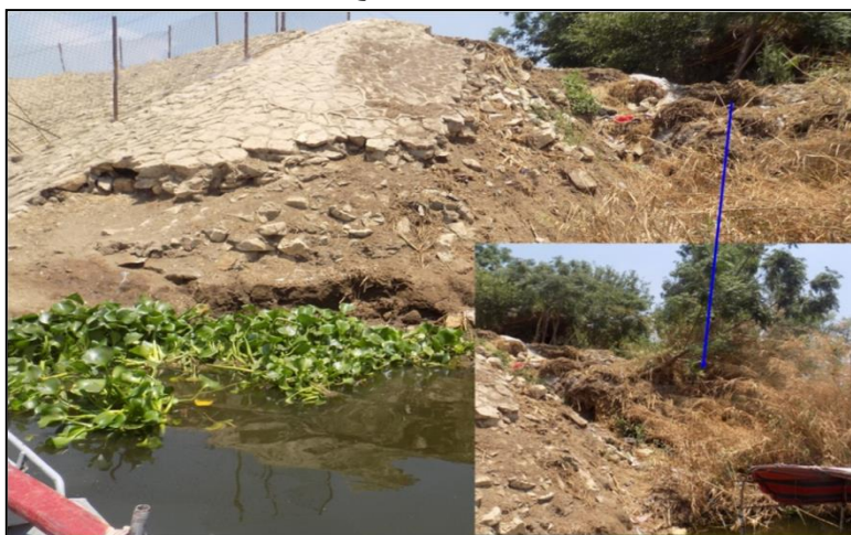
صورة (٨): انهيار أجزاء من رصيف محطة مياه النعناعية بالجانب الشرقي لمجرى فرع رشيد بقرية طنوب بالمنوفية اتجاه التصوير: ناظرا صوب الشرق تاريخ التصوير: ٢٠١٥/٤/١٣
