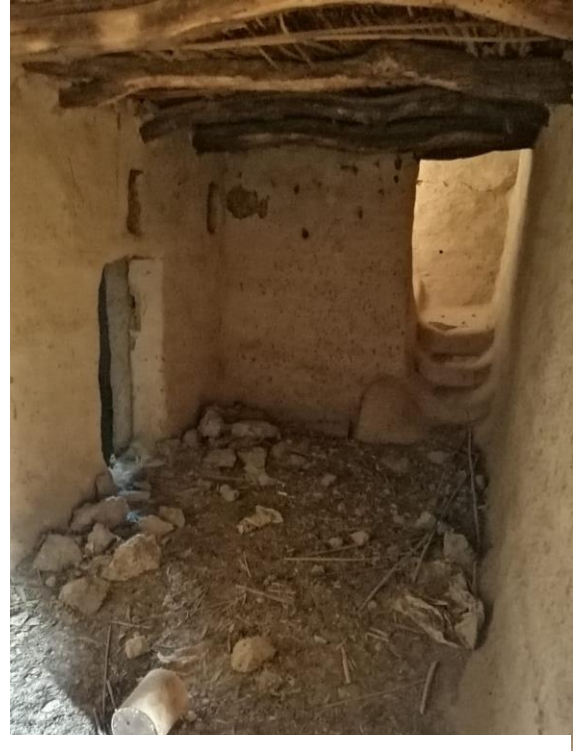
(لوحة ٧) تبيين الممر بعد فتحة الدخول بالواجهة الشمالية لمنزل عائلة محروس - بدخلو
