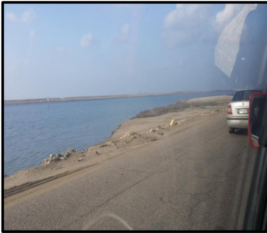
صورة ( ٨ ) تشققات علي طريق غرب ميناء شرق التفرعة بفعل التجوية الملحية
