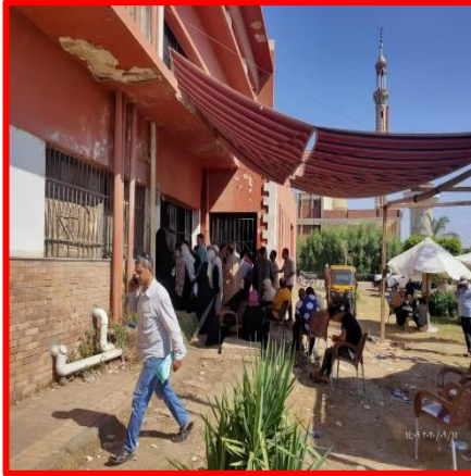
صورة (٣-ب): تزامم المواطنين لتقديم طلبات التصالح على مخالفات البناء، ١٢-٨-٢٠٢٠م، صفحة مجلس مدينة القناطر الخيرية.
